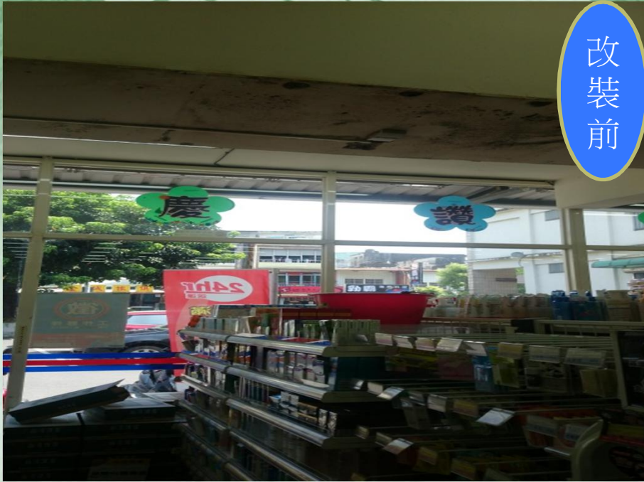
改裝前-天花板老舊
